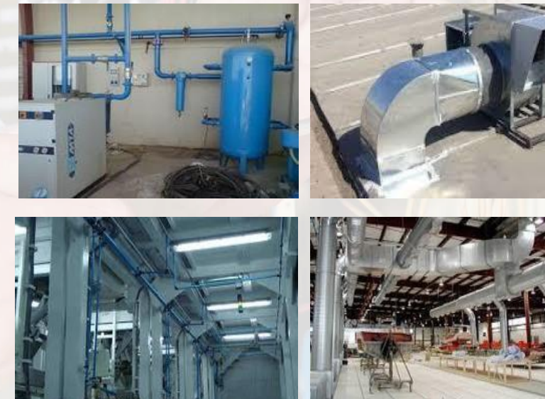
INSTALACIONES DE AIRE COMPRIMIDO Y DUCTERIA PARA EXTRACCION
